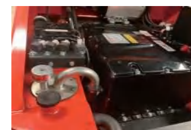
Удобный контроль уровня гидравлического масла. Easy inspection of hydraulic oil level.
